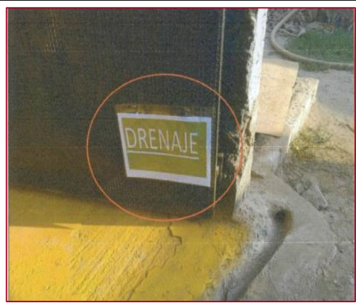
Se observa la señalización del sistema de drenaje
