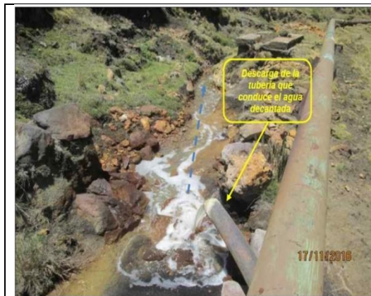
Fotografía N° 14: Vista fotográfica de la descarga de la tubería que conducía el agua decantada hacia el canal excavado en suelo.
