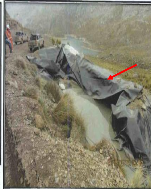
Fotografía N° 26: Presunto Incumplimiento N° 2. Vista Panorámica de la Poza de almacenamiento de agua sin identificación, se observó una poza revestida con geomembrana, que contaba con dimensiones aproximadas de 22 metros de largo y 6 metros de ancho.
