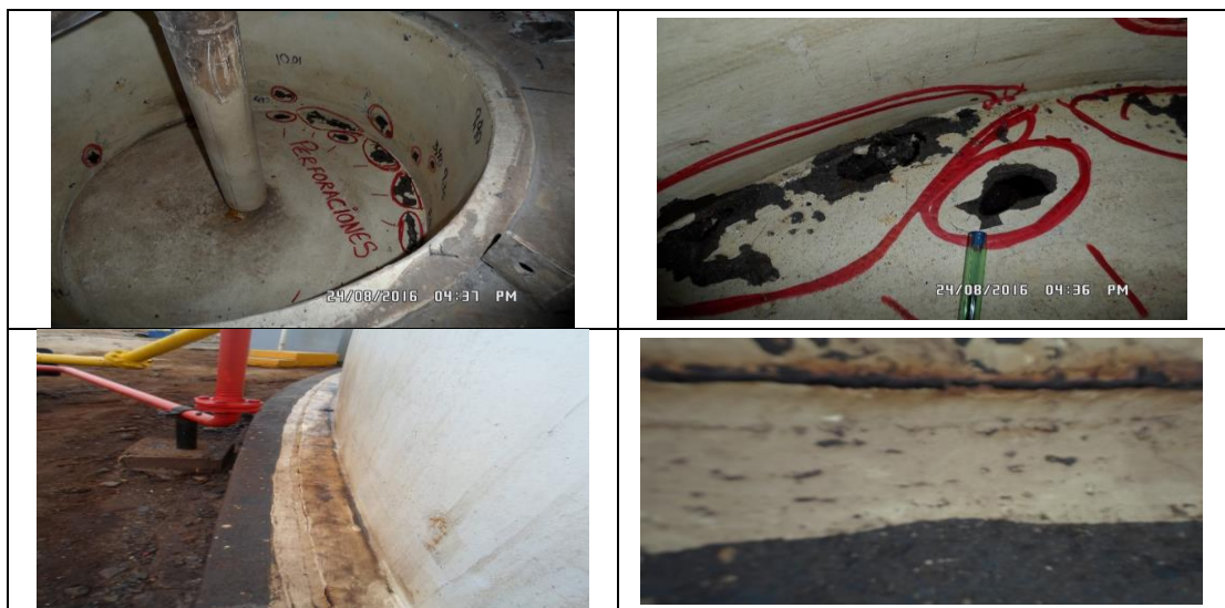
Imágenes que muestran las perforaciones en el sumidero y las pestañas en la parte exterior del tanque, por las cuales se habría producido la fuga del hidrocarburo almacenado en el Tanque N° 12 del Terminal Ilo.
