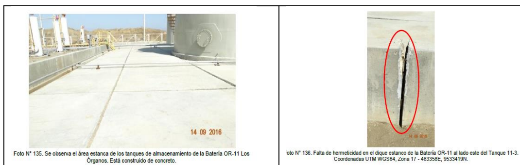
Cuadro N° 6: Fotografías de hecho detectado en la acción de supervisión
