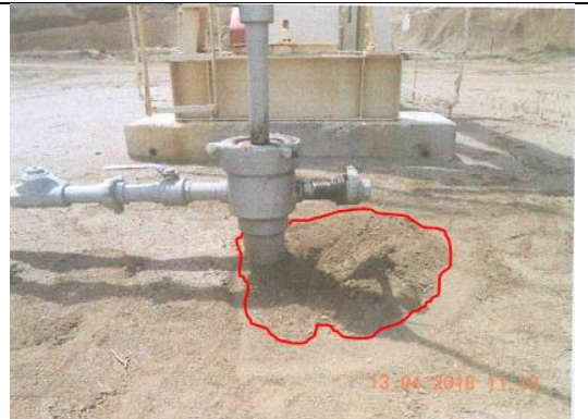
Foto N° 47. se observó suelo impregnado con hidrocarburos, en un área aproximada de 0.40 m x 0.40 m a una profundidad de 0.30 m. (Coordenadas UTM: 474370E - 9523503N)
