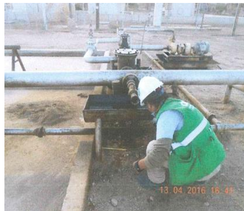
Foto N° 50. Se observó suelo impregnado con hidrocarburos en la zona de descarga de la producción de Suab, el área afectada fue de 1.40 m x 0.50 m (Coordenadas UTM: 474860E - 9527751N)
