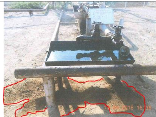
Foto N° 49. Se observó suelo impregnado con hidrocarburos en la zona de descarga de la producción de Suab, el área afectada fue de 1.00 m x 1.40 m (Coordenadas UTM: 474846E - 9527739N)
