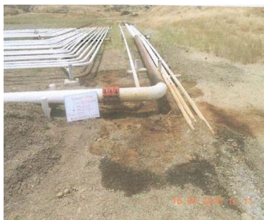
Foto N° 51. A 12 metros al suroeste de los manifolds de campo N° 10, 11, 12 y 13, altura de la línea de totales, se observó suelo impregnado con hidrocarburos en un área de 5.00 m x 2.00 m y una profundidad 0.15 m. Coordenadas UTM Sistema WGS84 471837E 9526023N
