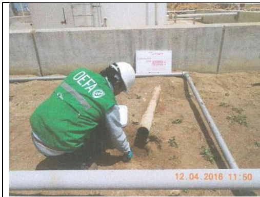
Foto N° 43. Zona externa al área estanca, se observó suelo impregnado con hidrocarburos, en un área aproximada de 0.40 m x 0.40 m a una profundidad de 0.30 m. Coordenadas UTM Sistema WGS84 474114E 9523344N
