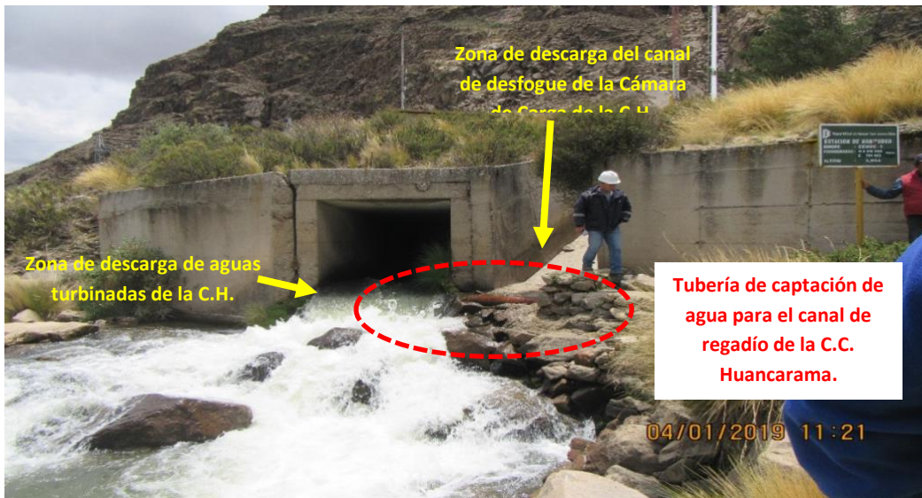
Fotografía N° H5-4: Vista de la tubería metálica de captación de agua para el canal de regadío de la C.C. Huancarama, la cual se encuentra conectada directamente con el punto de descarga de aguas turbinadas de la C.H. Huancarama.
