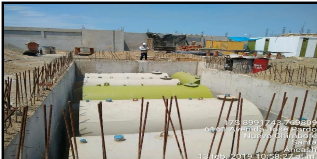
Imagen correspondiente a una estructura de concreto armado en forma de L, con seis (6) tanques de hierro, obtenidas por la OE Chimbote durante la Supervisión Especial 2019.
