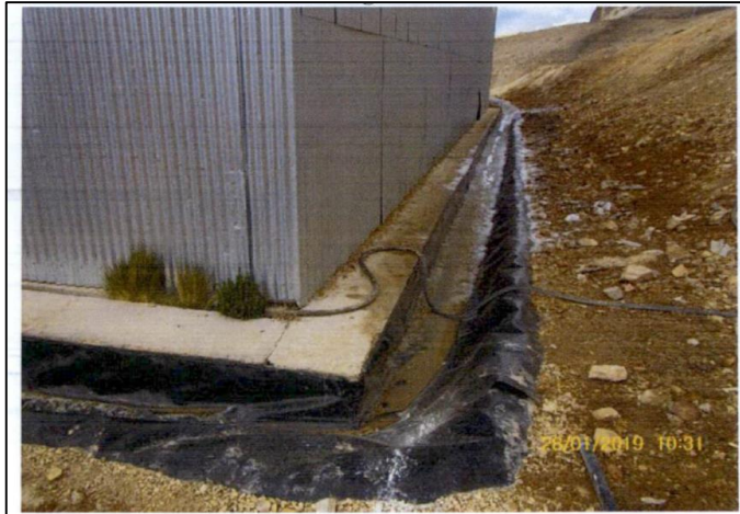
Fotografía N° 2: Vista del canal de coronación del almacén de cal. Se observa que está impermeabilizado con geomembrana. La foto corresponde a la parte superior e inicio del canal.
