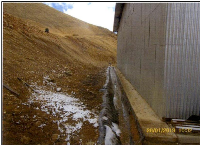
Fotografía N° 3: Vista del canal de coronación del almacén de cal, impermeabilizado con geomembrana. La foto corresponde a la misma sección que la fotografía N° 2, vista desde el otro extremo.
