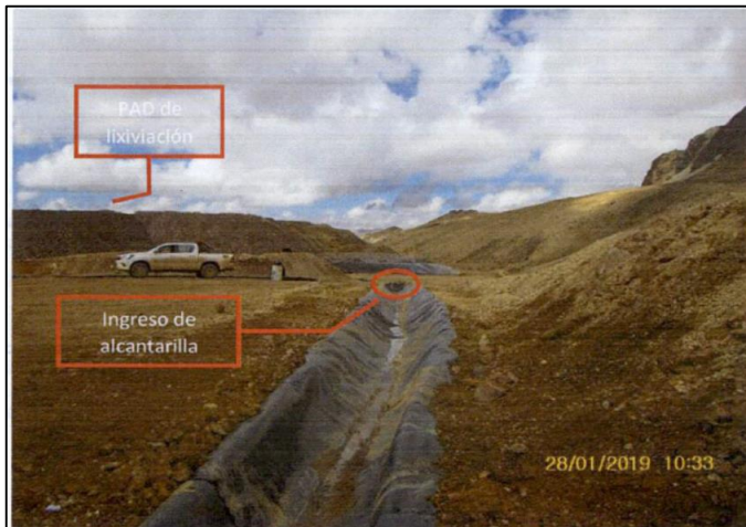
Fotografía N° 4: Vista de la continuación del canal de coronación del almacén de cal, impermeabilizado con geomembrana.
