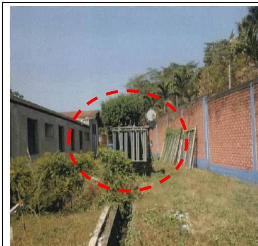
Fotografía N° 6: Vista del área donde se encontraron instaladas las celdas de los transformadores, actualmente se aprecia que estas celdas se encuentran tapadas, donde los transformadores fueron retiradas del lugar. Al fondo se puede apreciar el transformador de potencia dispuesto sobre el suelo sin sistema de protección ante eventual derrame o desfogue de aceites.
