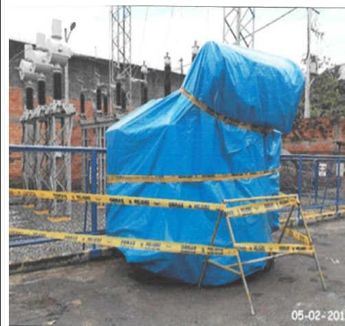
Vista fotográfica: Almacenamiento del transformador a la SE Tarapoto.
