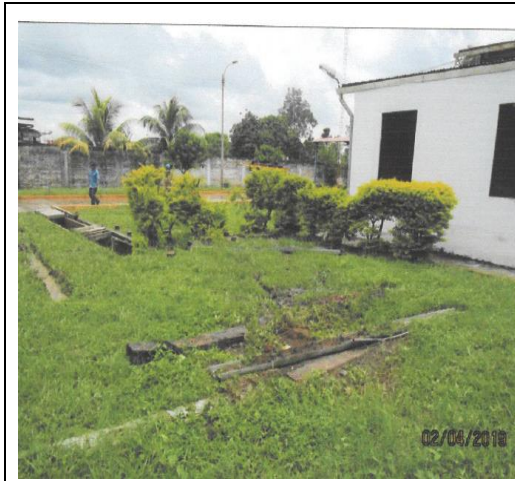
Vista fotográfica: Zona donde se ubicaba el transformador inoperativo ubicado en la Ex Central Termoelectrica Juanjui, con coordenadas UTM 308226 Este y 9206104 Norte
