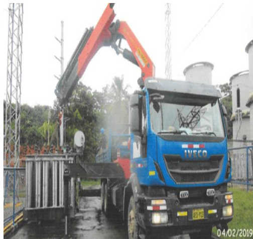
Vista fotográfica: Descarga del transformador inoperativo en la SE Tarapoto.
