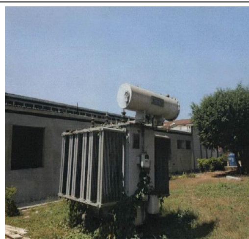
Fotografía N° 7: Se observa el detalle del transformador de potencia dispuesto sobre suelo con cobertura vegetal.
