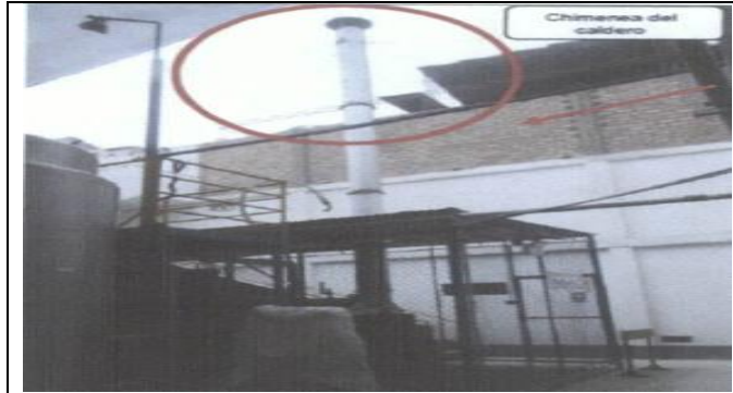
Fotografía N° 6: Vista del caldero, el mismo que utiliza combustible petróleo Diésel 2, cuyas emisiones atmosféricas, son evacuadas a través de una chimenea de caldero, las misma que se encuentra sobre el nivel del techo.
