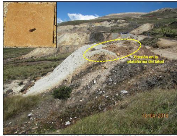
Fotografía N° 12: Vista panorámica del Depósito de Desmonte 7735. Se observó presencia de erosión en la plataforma del talud; de igual forma, se observó caída de rocas. El depósito se encontraba expuesto a la intemperie.
