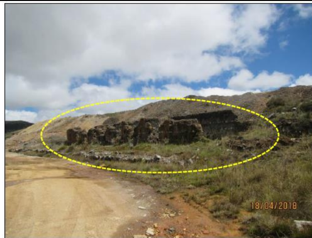
Fotografía N° 23: Infraestructura 2 (identificada en campo como CL-5). Ubicada en las coordenadas UTM WGS 84 - Zona 17: N 9255684; E 758903. Se observó construido con material de tapial sobre una plataforma antigua, la cual estaba colapsada (muros ruinosos).
