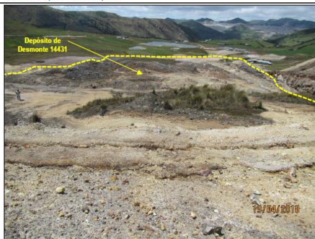
Fotografía N° 39: Depósito de Desmonte 14431 (identificado en campo como CL-03). Ubicado en las coordenadas UTM WGS 84 Zona - 17: N 9255684; E 758802. Se verificó que el desmonte se encontraba dispuesto en runas dispersas sobre la cresta del talud.
