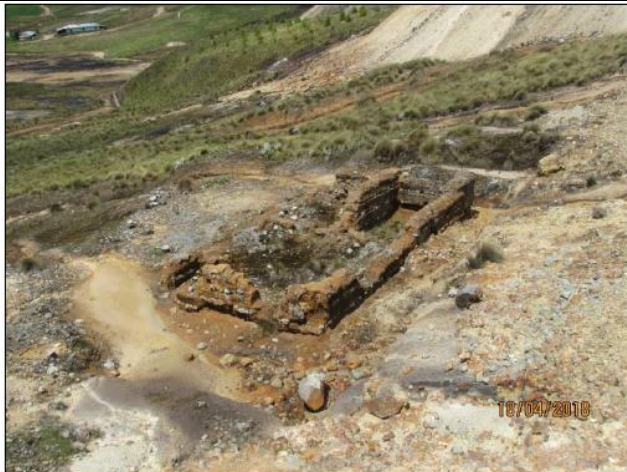
Fotografía N° 7: Vista panorámica de la Infraestructura 1. Ubicada en las coordenadas UTM WGS 84 - Zona 17: N 9255739; E 759001. Se observó construido con material de tapial sobre una plataforma antigua, la cual estaba colapsada (muros ruinosos).
