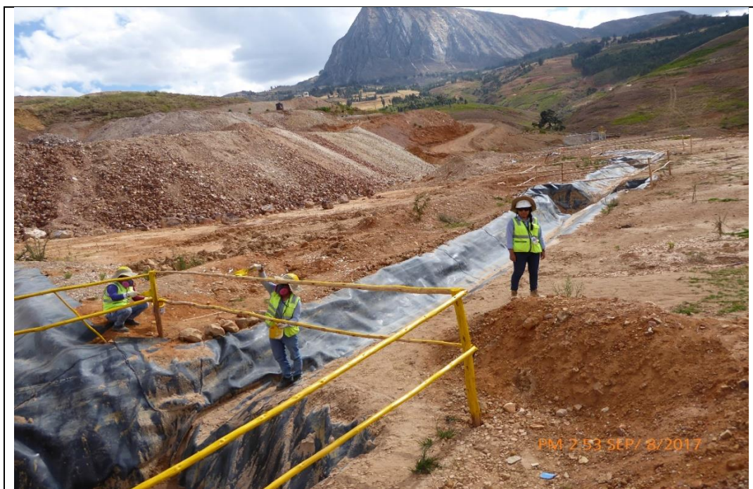
FOTO N° 161: Presunto Incumplimiento N° 3, Supervisión 2017: Deposito de material estéril Choloque (DME Choloque), donde no se tiene implementada la poza de agua de infiltración (efluente).
