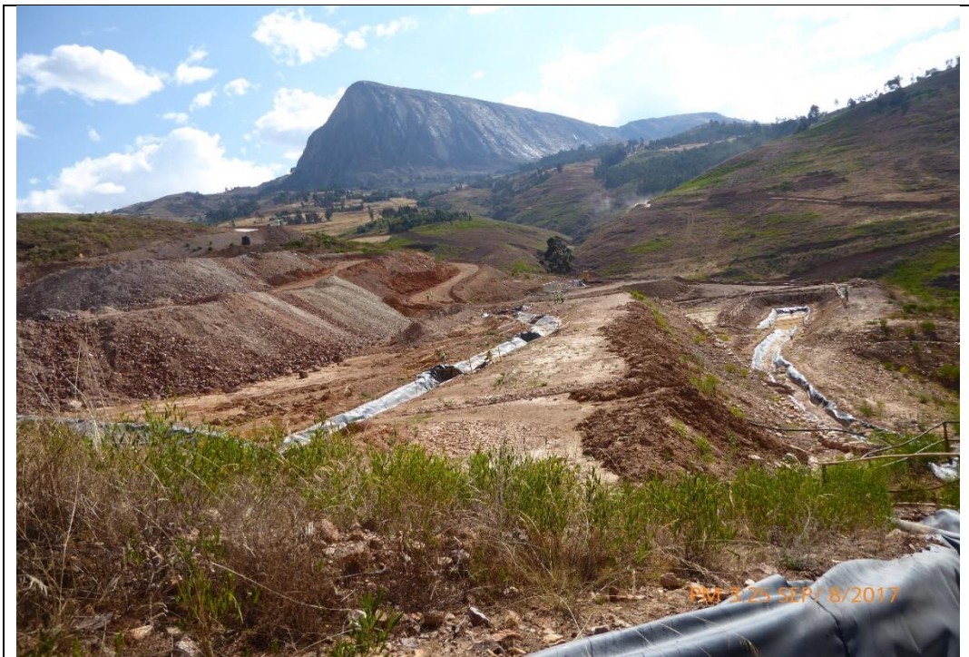
FOTO N° 162: Presunto Incumplimiento N° 3, Supervisión 2017: Otra vista del depósito de material estéril Choloque (DME Choloque), donde no se tiene implementada la poza de agua de infiltración (efluente).
