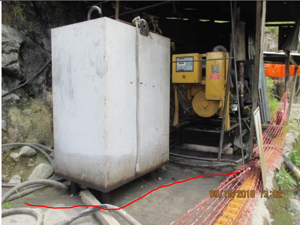
Fotografía H1-2.- Debajo del tanque de combustible, así como debajo del grupo electrógeno se puede observar manchas oscuras producto de la mezcla de agua de lluvia con restos de hidrocarburo (contorno en línea roja).
