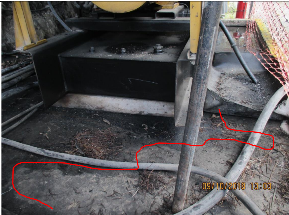
Fotografía H1-3.- La mancha de hidrocarburo debajo del grupo electrógeno en la zona del alternador (delimitado por la línea roja) y se extiende dentro de la losa de concreto, mezclándose con el agua de lluvia.
