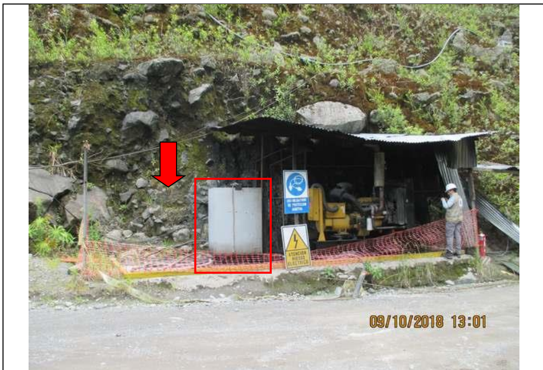
Fotografía H1-1.- Grupo electrógeno junto al tanque de combustible (cuadro rojo) ubicados sobre una losa de cemento. Se observa que el tanque de combustible y el grupo se encuentra colindante al talud del cerro (flecha de color rojo).
