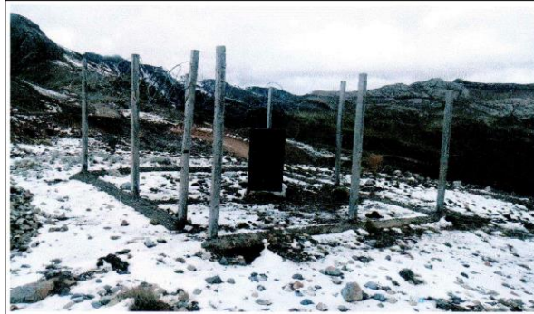
FOTO N° 01. Vista general de área de ubicación de antena de radio.
