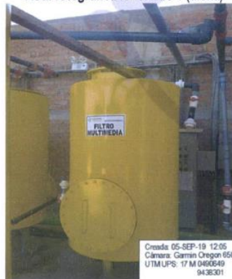
Vista fotográfica N° 3: filtro 3 (multimedia que ha reemplazado al primero de cuarzo de la miniplanta)
