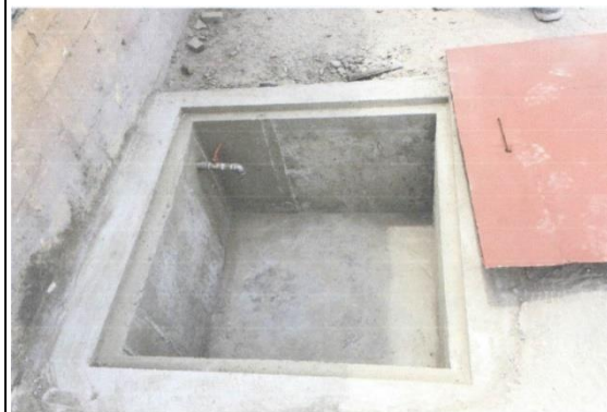
Fotografía N° 4 – Cámara de contención de aceite (vista interior)
