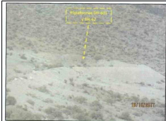
Fotografía N° 17. Incumplimiento N° 1: Vista panorámica del área de la plataforma DDH-601 y plataforma DDH-62, donde se observó que el área de las plataformas presentaban el corte del talud realizado en el terreno.
