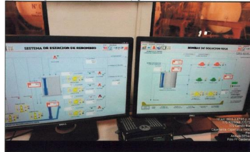
Captura de imagen a las 3:47:05 p.m.: inicio de apagado automático de bombas.
