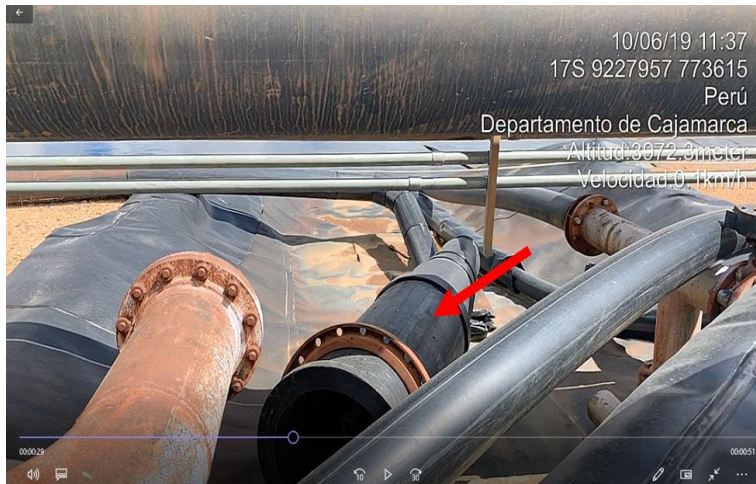
Fuente: Descargos al Informe Final
