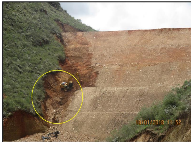
Fotografía N° 11. Vista del canal de derivación erosionado, se observa una maquinaria realizando los trabajos de conformación en la zona afectada.
