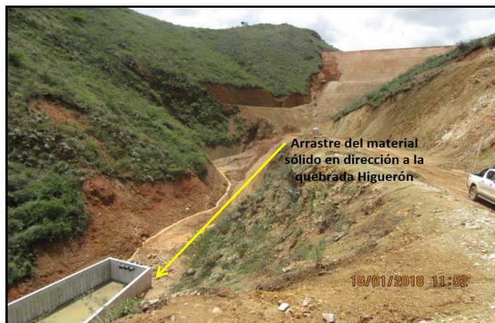
Fotografía 13. Vista panorámica del canal erosionado y la dirección a la quebrada Higuieron. En la vista también se observa la Poza de Infiltración 1, la cual se encontraba en proceso de construcción.
