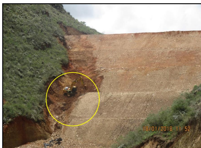
Fotografía 11. Vista del canal de derivación erosionado, se observa una maquinaria realizando los trabajos de conformación en la zona afectada.
