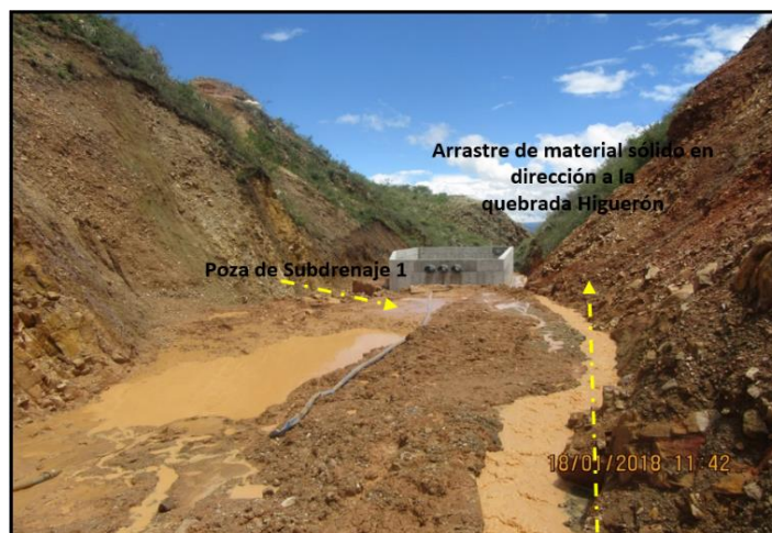
Fotografía 14. Nótese el agua que descendía desde el canal de derivación erosionado y que iba en dirección a la quebrada Higuieron.
