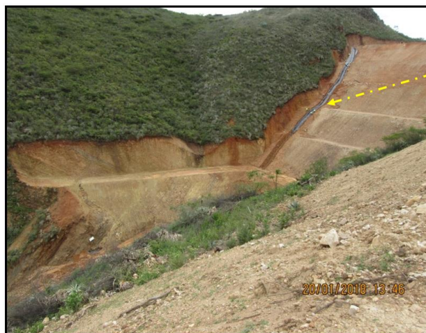
Fotografía N° 17. Nótese en la vista la conformación y revestimiento con geomembrana del Canal de Perimetral 1C Tramo 2, que había sido erosionado.
