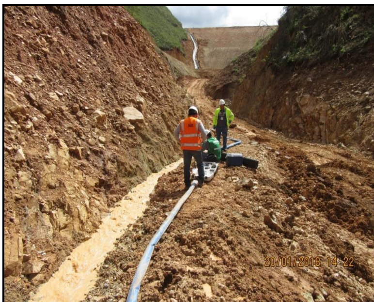
Fotografía N° 23. Vista aguas arriba del lugar donde se tomó la muestra, donde se observa el agua con sedimentos que viene discurriendo hacia la quebrada Higerón.
