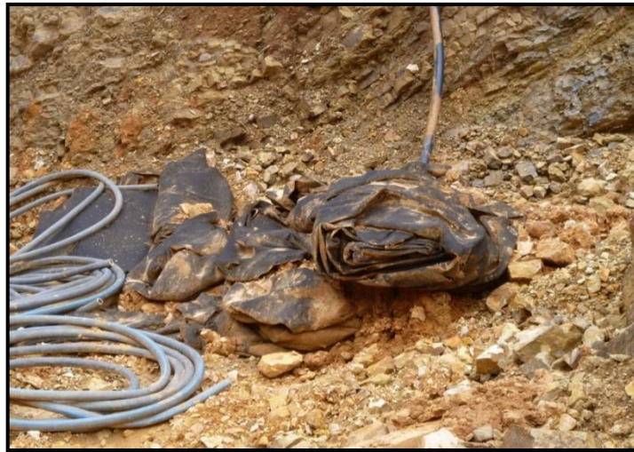
Fotografía 12. Vista donde se observa los restos de la geomembrana que estuvo colocado en el canal de derivación erosionado.
