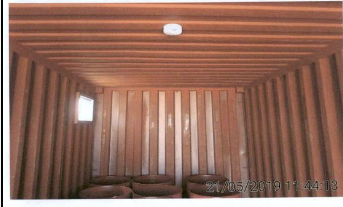
Foto N° 9. Almacén de residuos Peligrosos, sistema contra incendios (alarma de humo).
