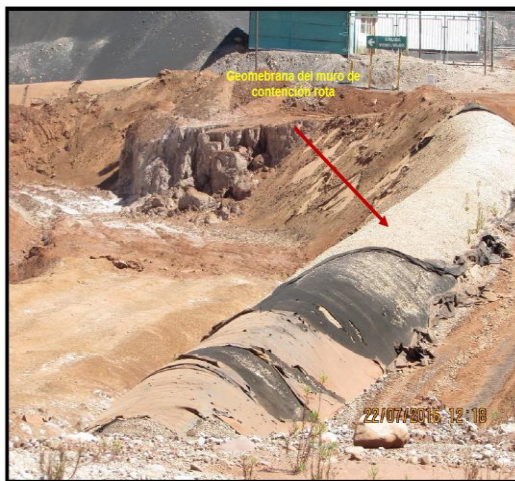
FOTOGRAFÍA N° 97: Depósito de Ferritas de Zinc de Huanchán. Vista del interior de la poza de almacenamiento de ferritas de zinc, donde se observa que en algunos tramos del dique de contención la geomembrana está rota.
