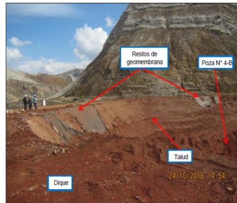
Fotografía N° 5: Vista del punto D2, coordenadas UTM datum WGS 84 Zona 18: 8 723 913N, 403 483E, desde donde se observaba la zona Este de la Poza N° 4-B. Se evidenció restos de geomembrana en el talud de la Poza.
