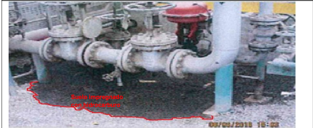
Registro fotográfico N° 125. Se observa el suelo impregnados con hidrocarburos. Coordenadas UTM (WGS 84): N 8681230; E 267757.
