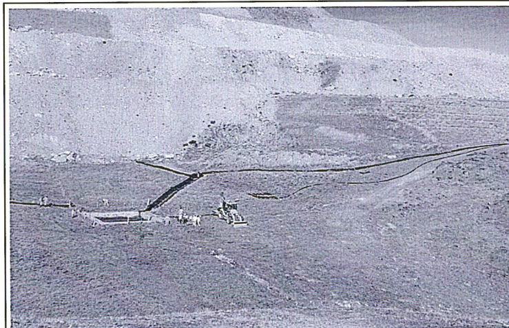
Se puede observar que en dicha poza se ha acondicionado un sistema de Bombeo de las aguas de contacto, y ya no se tiene ninguna descarga al medio ambiente, estas aguas son enviadas hacia La Mina, mediante 3 estaciones de bombeo.
