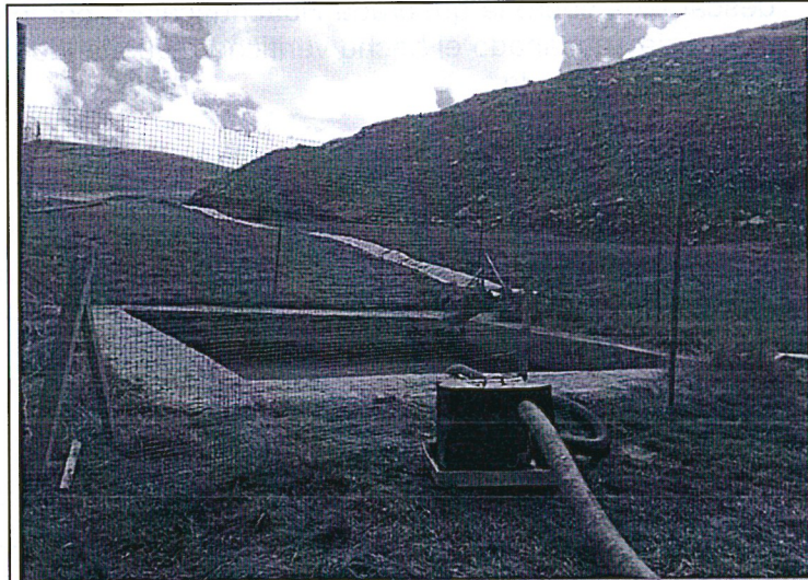
Se puede observar que en dicha poza se ha instalado un cerco metálico y se ha acondicionado un sistema de Bombeo de las aguas de contacto, que luego son enviadas hacia La Mina
