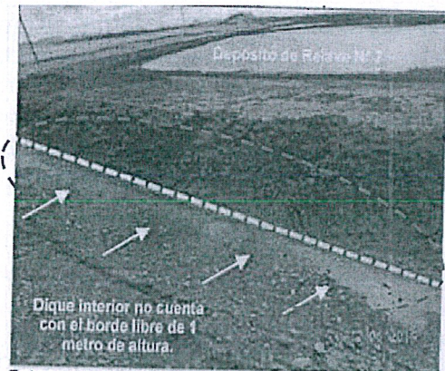
Fotografía N° 66 (contenida en el anexo N° 5 del Informe Preliminar) Hallazgo N° 8.- Vista cercana en la que se aprecia inexistencia del borde libre de un metro entre el nivel del relave y la cresta del dique, también se observa el espejo de agua de dicho Depósito de Relaves.
