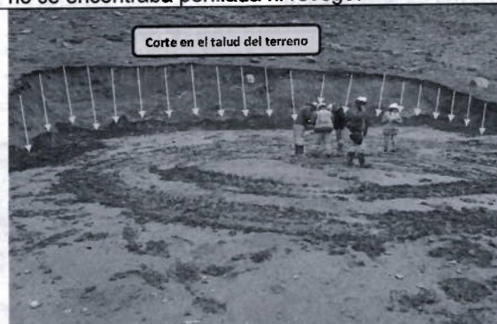
Fotografía N° 11. Vista del área de la plataforma P4 (coordenadas UTM WGS 84 Zona 18 E 387 758 N 8 698 106). Presentaba dimensiones de 15,00 m de largo por 10,00 m de ancho, además, un corte de talud expuesto de aproximadamente 5,00 m de altura. Dicha área no se encontraba rellena, perfilada, ni revegetada.
