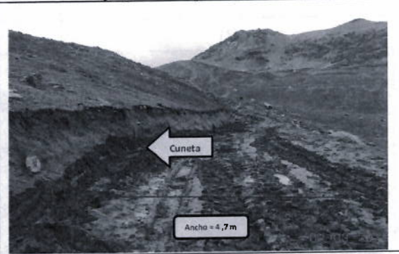
Fotografía N° 14. Acceso que va hacia la plataforma P4 (coordenadas UTM WGS 84 Zona 18; E: 387 753, N: 8 698 122). 698 998). El área no se encontraba rellena, perfilada ni revegetada. Presentaba un ancho de 4,7 m y una cuneta excavada en tierra al lado del acceso de 0,9 m de base mayor, 0,45 m de base menor y 0,25 m de profundidad.
