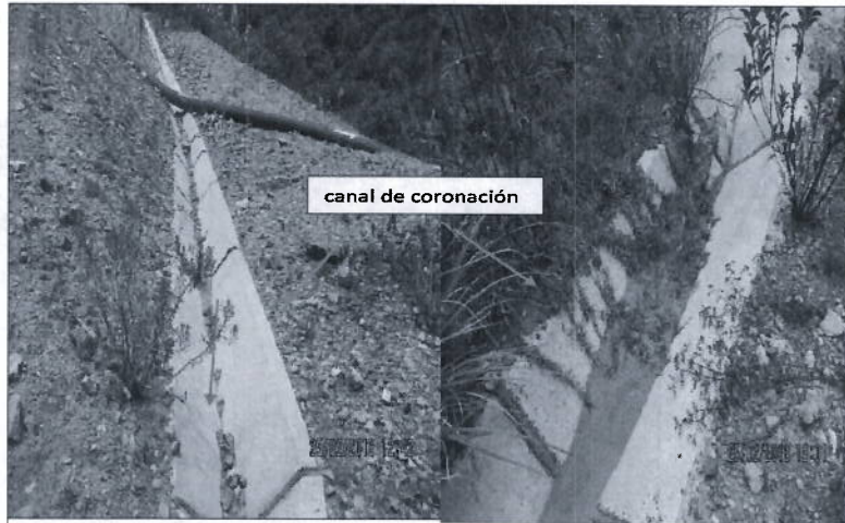
Fotografía N° 35. Vista de los canales de coronación, en la que se observa la presencia de piedras y arena al interior de los mismos.
