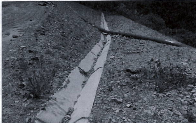
Fotografía N° 34. Vista de canal de coronación que deriva aguas al río Mischa, ubicado aguas abajo de la planta de filtrado.
