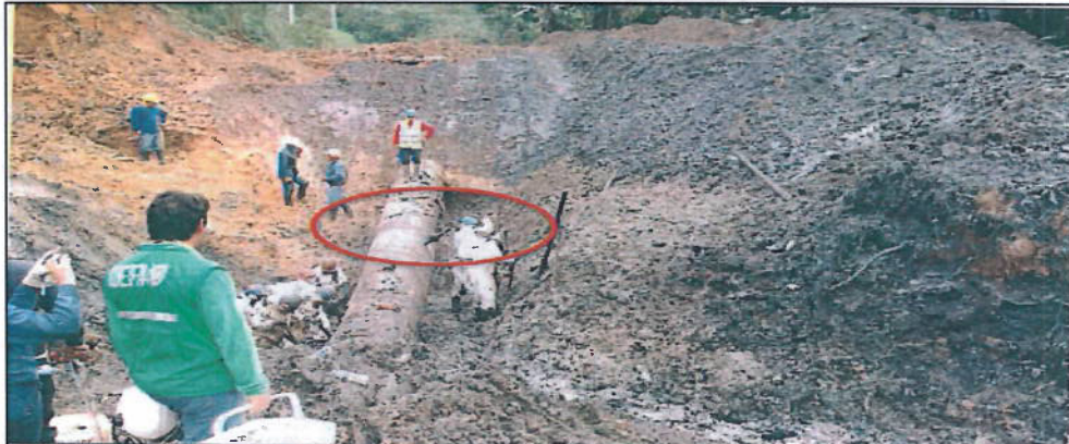
Foto 11: Vista del punto del derrame de petróleo crudo, se observa que el derrame ya fue controlado.
