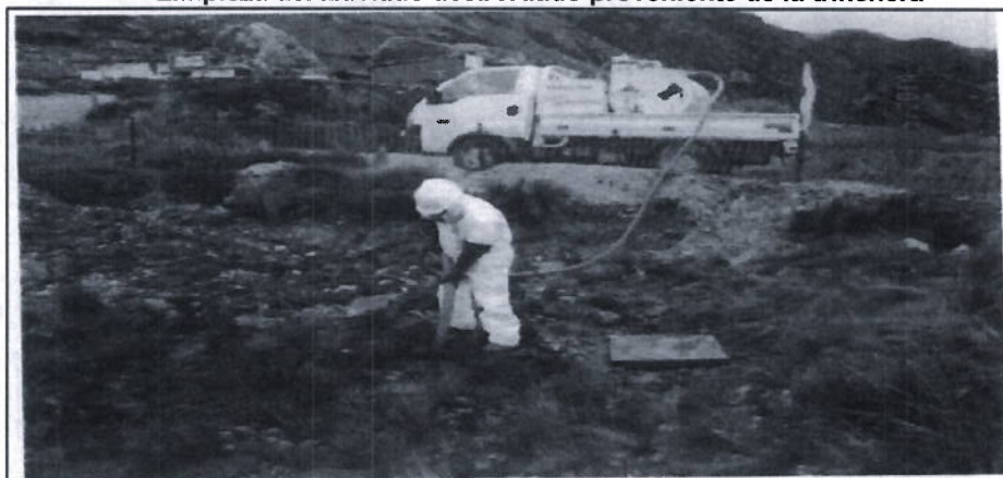
Limpieza del lixiviado desbordado proveniente de la trinchera
