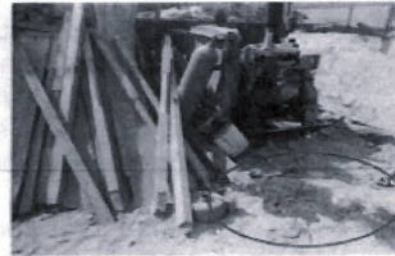
FOTO N° 34. Se observan sobre terreno afirmado, la acumulación de terreno empregnado con aceite proveniente de las maquinarias en desuso.
