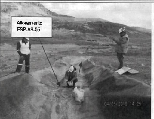
Fotografía N° 11: Afloramiento (ESP-AS-05) ingresando a través de una abertura de la geomembrana del canal lado norte de agua de no contacto en dirección a la quebrada Apostoloni .
