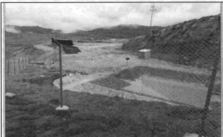
Fotografía N° 53: Vista de la poza de sedimentación final, de la cual descargaba el flujo de aguas por rebose hacia la quebrada, se aprecia un tramo en canal de mampostería.
