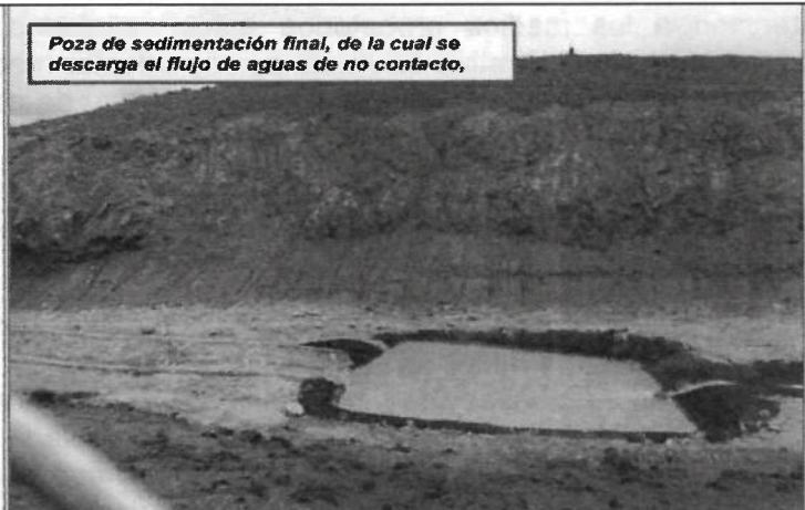
Fotografía N° 52: Vista de la poza de sedimentación final, de la cual descargaba el flujo de aguas por rebose hacia la quebrada, se aprecia un tramo en canal de mampostería.
