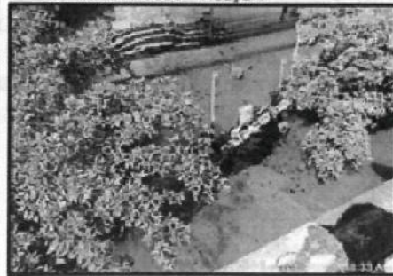
Fotografía N° 8 Barrera de contención insuficiente a orillas de quebrada s/n a la altura de puente Km 54 de la carretera Andoas - Huayuri.
