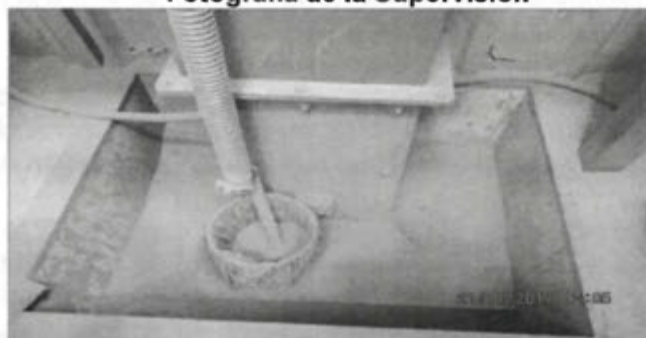
Foto N° 11: Residuo de granalla, recolectado en balde, en el sistema de recolección, cuyo residuo es la acumulación del material particulado, por sedimentación debido a la gravedad. Se aprecia que el área cuenta con un dique de concreto, el cual está conteniendo la granalla residual, sin la señalética respectiva.
