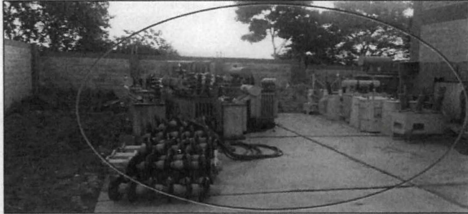
Fotografía N° 2.- Al lado izquierdo de la puerta de ingreso al almacén de materiales de la C.T. Tarapoto, se observó aprox., 20 transformadores de distribución en calidad de residuo.
