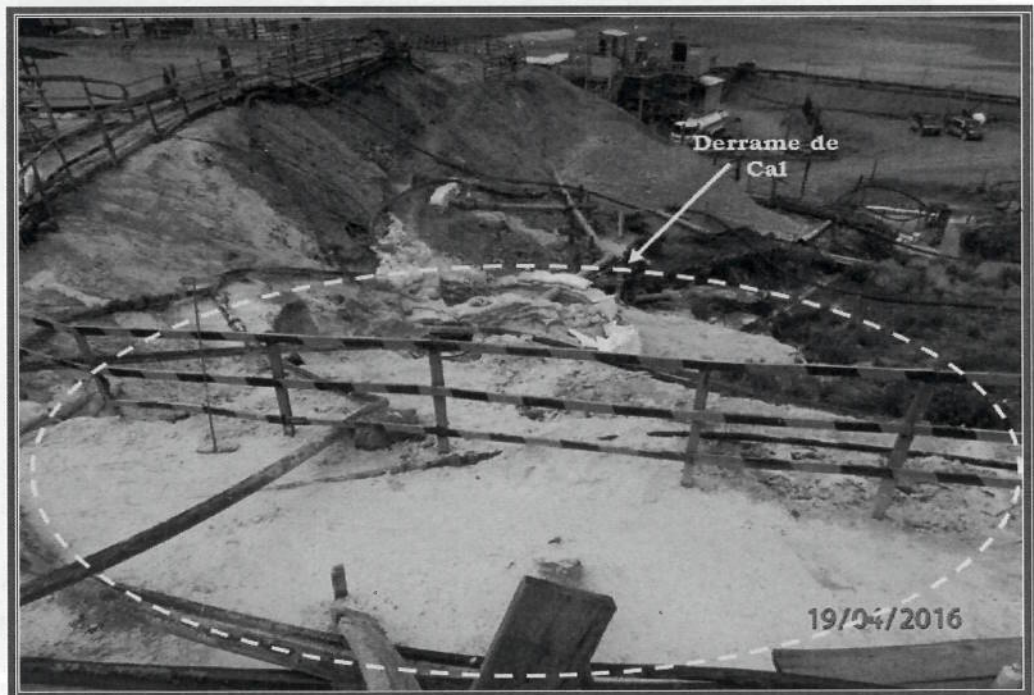
Fotografía N° 145: Hallazgo 9: Vista fotográfica donde se observa derrame de cal sobre la ladera al costado del dosificador de cal.
