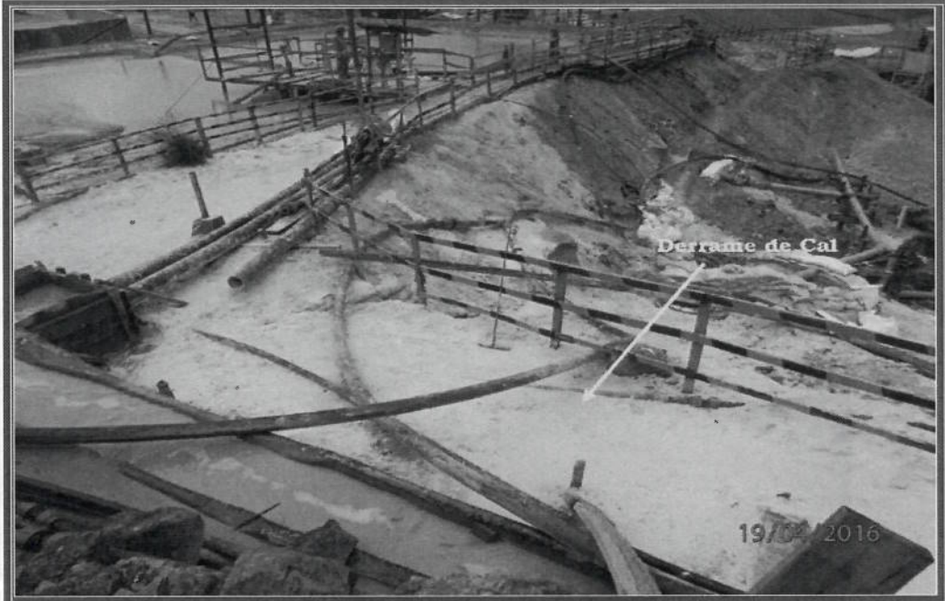
Fotografía N° 144: Hallazgo 9: Vista fotográfica donde se observa derrame de cal sobre la ladera al costado del dosificador de cal.
