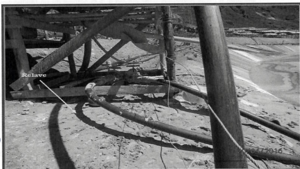
Fotografía N° 167: Hallazgo 15: Vista fotográfica donde se observa material de relave sobre el suelo alrededor del cicloneador sur, ubicado en las coordenadas UTM WGS 84 501325 E, 8555699 N.
