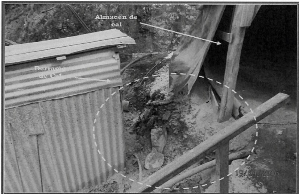
Fotografía N° 146: Hallazgo 9: Vista fotográfica donde se observa derrame de cal sobre el suelo alrededor del almacén temporal de cal que abastece al dosificador de cal.
