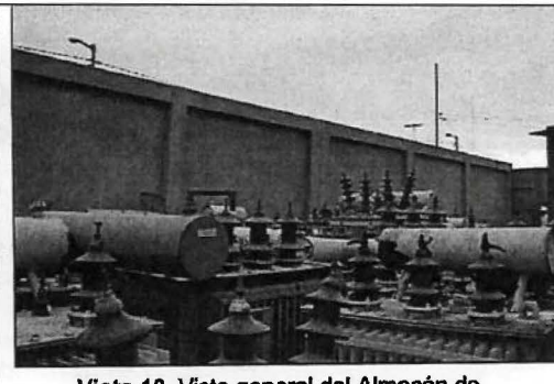
Vista 10. Vista general del Almacén de transformadores con aceite dieléctrico (residuo peligroso) sin techo.
