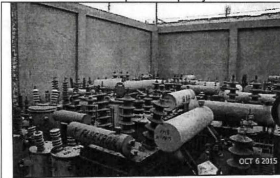
Vista 9. Área del almacén de transformadores con aceite dieléctrico (residuo peligroso) sin techo.
