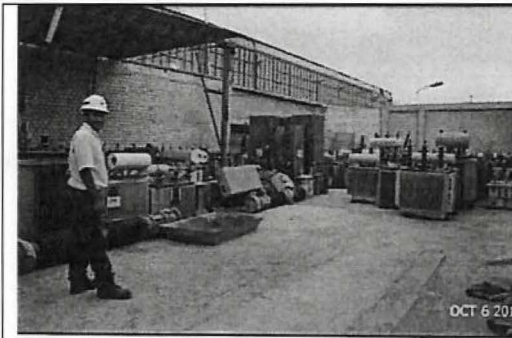
Vista 7. Almacén N-2A de transformadores dados de baja y de segundo uso con aceite dieléctrico (residuo peligroso).
