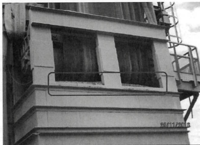
Fotografía N° 97. Hallazgo N° 3.- Vista de concentrado de la zona de transferencia de la faja transportadora CT 1 y CT 2, se observa la acumulación en la estructura metálica.
