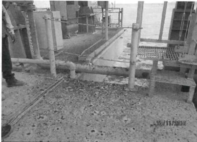
Fotografía N° 98. Hallazgo N° 3.- Vista de concentrado húmedo en el borde del muelle ubicado en la zona de transferencia de la faja transportadora CT 1 y CT 2.
