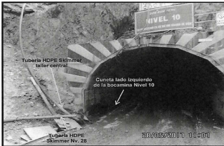
FOTOGRAFÍA N° 7: Tuberías de descarga de agua proveniente del Skimmer del Nv. 28, Skimmer Taller Central y del interior de la bocamina del Nv. 10 a través de una cuneta del lado izquierdo.
