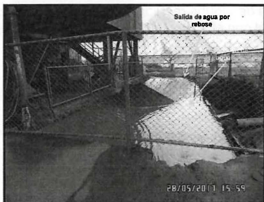
FOTOGRAFÍA N° 55: La fotografía muestra acumulación de agua en la poza de sedimentación adyacente a la sección de chancado secundario y terciario así como salida de agua por rebose hacia un canal de concreto.
