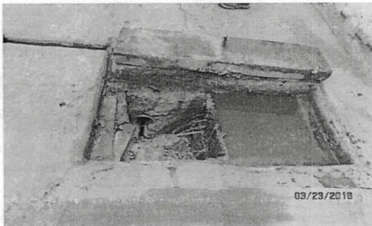
Fotografía N° 02: Punto de descarga del efluente industrial hacia la red de alcantarillado público.
