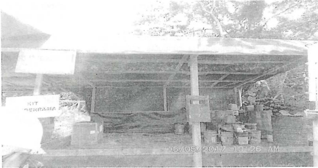
Fotografía 102-1. Vista frontal del almacén de residuos líquidos peligrosos, el mencionado almacén es un ambiente rústico con una geomembrana deteriorada que se encuentra en el piso y paredes laterales de este. Es preciso mencionar que este almacén se encuentra rodeado de vegetación.
