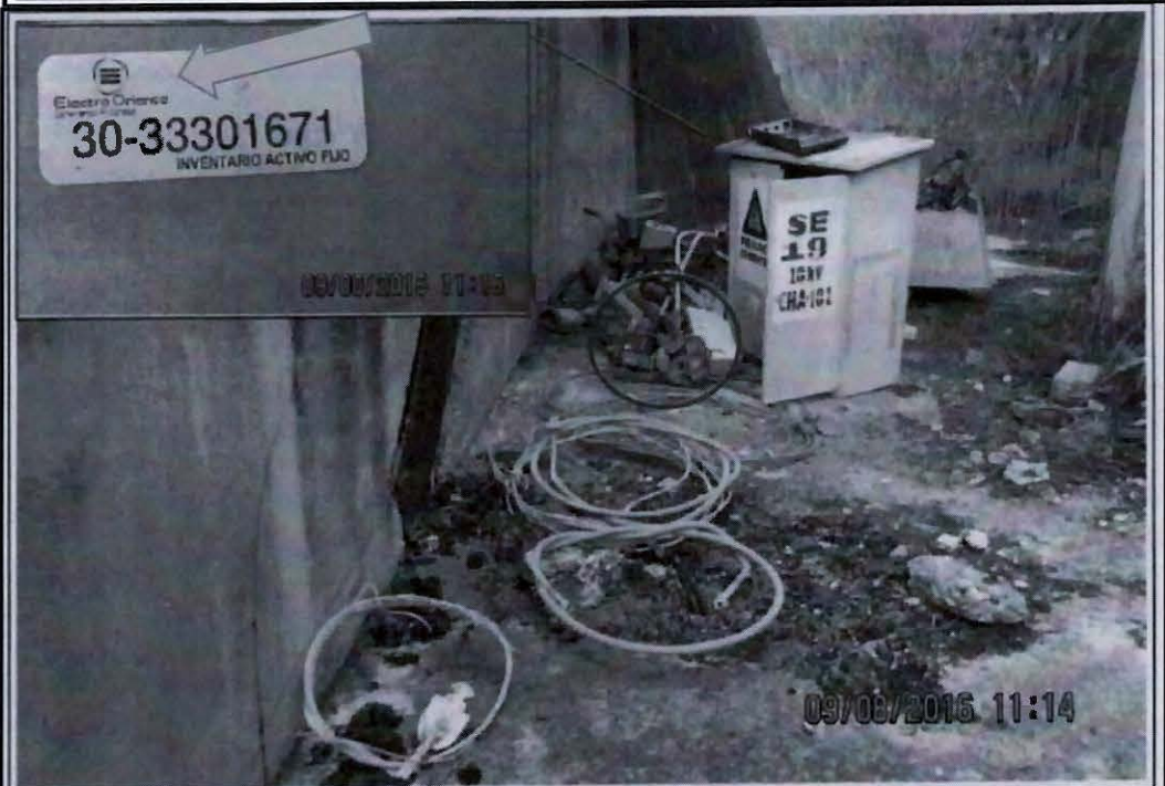
Fotografía N° H02-E: Vista de los residuos: tableros de control, el que cuenta con etiqueta de inventario 30-33301671, activo fijo de Electro Oriente, donde además se observan cables metálicos, desbrozadora (RAEE) y otros residuos.
