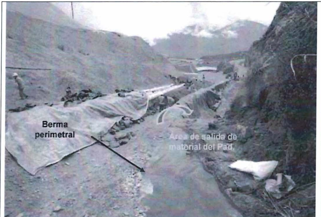
Fotografía N° 49: Se observó material del Pad de lixiviación pegado a la berma de contención, asimismo se constató que dicho material se encontraba fuera de la mencionada berma. Coordenadas UTM Datum WGS84: 8951826 N y 215340 E.
