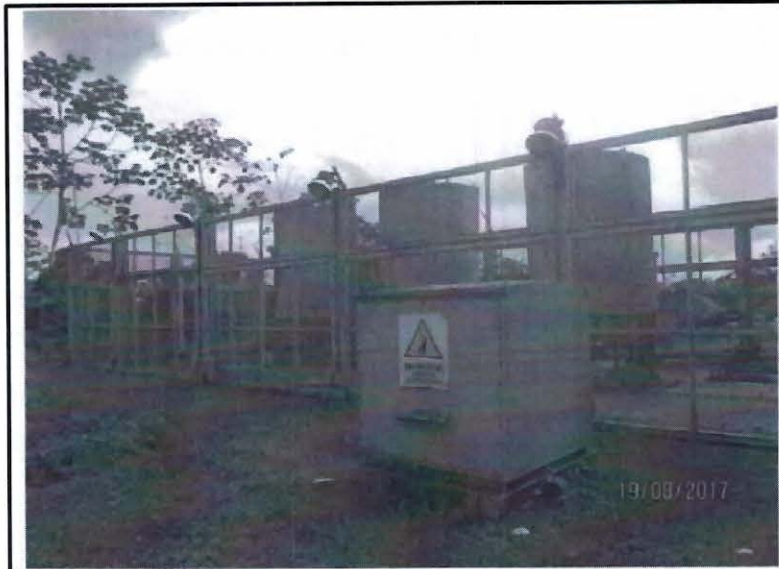
Fotografía N° 02. Coordenadas UTM, WGS 84: N 8685243, E 755893 / Reactores de la subestación eléctrica.
