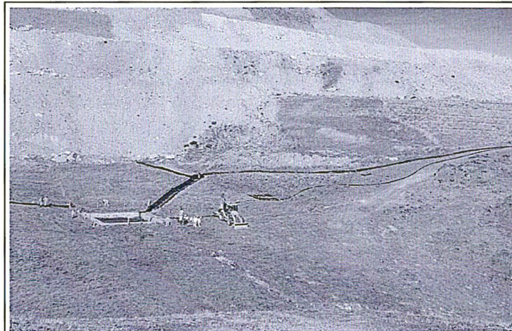
Se puede observar que en dicha poza se ha acondicionado un sistema de Bombeo de las aguas de contacto, y ya no se tiene ninguna descarga al medio ambiente, estas aguas son enviadas hacia La Mina, mediante 3 estaciones de bombeo.
