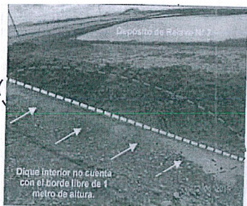
Fotografía N° 66 (contenida en el anexo N° 5 del Informe Preliminar) Hallazgo N° 8.- Vista cercana en la que se aprecia inexistencia del borde libre de un metro entre el nivel del relave y la cresta del dique, también se observa el espejo de agua de dicho Deposito de Relaves.
