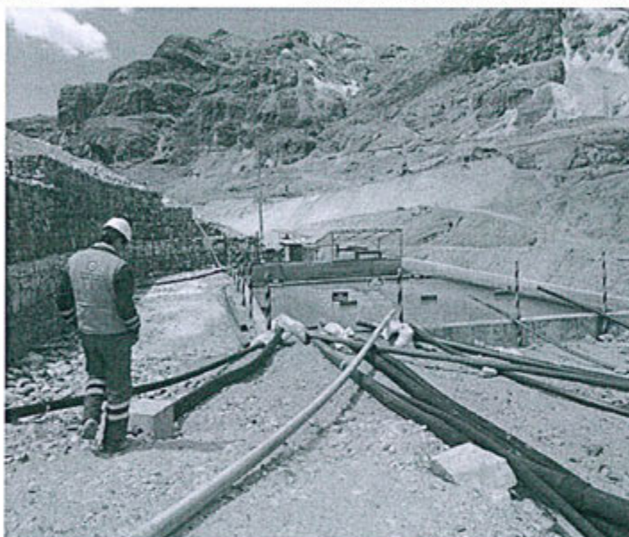
Fotografía N° 10: Se observa las líneas de captación de las aguas de sub drenes del depósito de relaves C.
