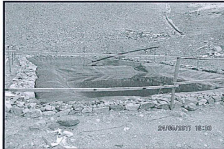
FOTOGRAFÍA N° 44: Vista de la poza colección de subdrenaje y escorrentías de la cancha de relaves C ubicada al pie del talud del dique de contención de la cancha en mención.
