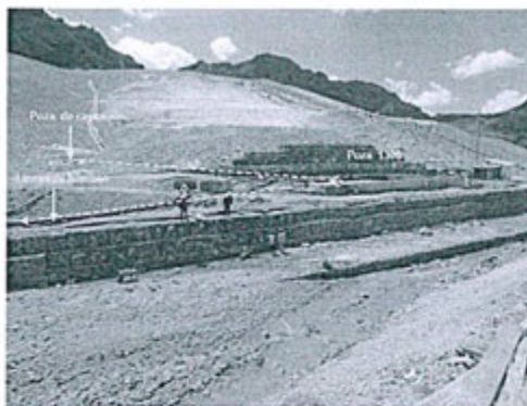
Fotografía N° 9: Vista panorámica de la Pozo 1300 - Sistema de captación de sub drenes del Depósito de relaves C, ubicado con en las coordenadas WGS 84 N 8556971, E 501468
