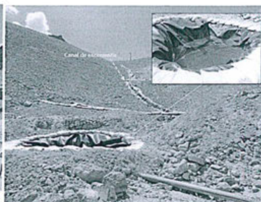
Fotografía N° 12: Vista fotográfica de la Pozo de colección de las aguas de sub drenaje
