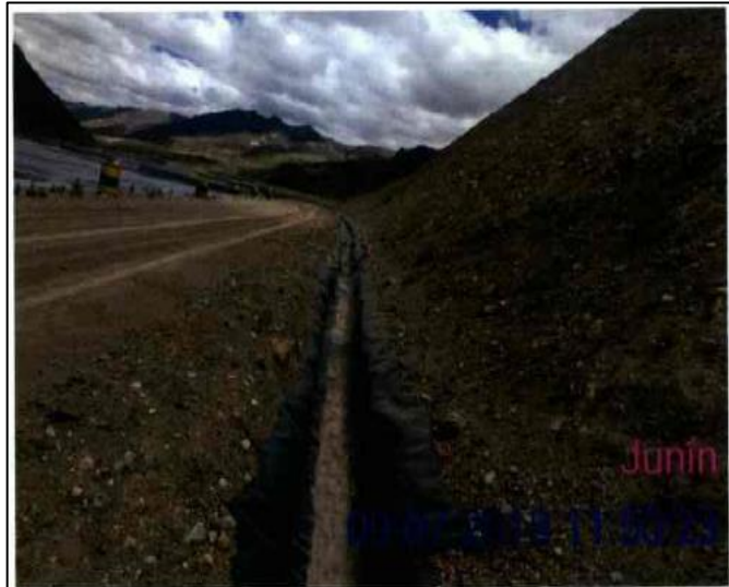
Foto N°9: Canales de conducción de escorrentía de la relavera N°6 en las coordenadas WGS84 18L 8715030 N y 386382 E
