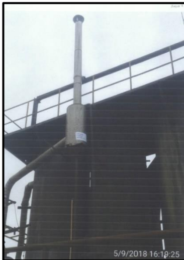
Torre Lavadora de Gases
