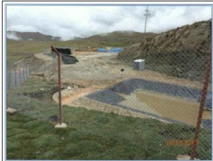
Fotografía N° 53: Vista de la poza de sedimentación final, de la cual descargaba el flujo de aguas por rebose hacia la quebrada, se aprecia un tramo en canal de mampostería.
