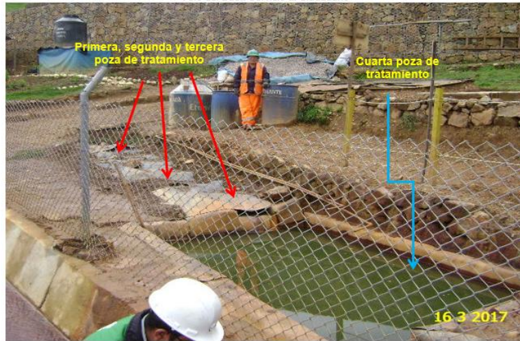
Fotografía N° 32: Vista del sistema de tratamiento del sub-drenaje del depósito de relaves N° 5, ubicado en coordenadas UTM (WGS 84), E 767207, N: 9253749, el cual consiste de un tratamiento combinado, pasivo y activo; en las pozas 1, 2 y 3 se realiza el tratamiento pasivo, consistente en un lecho de estiércol en la primera poza, luego lechos de piedra caliza en la segunda y tercera poza de tratamiento y finalmente el tratamiento activo en la cuarta poza de tratamiento.
