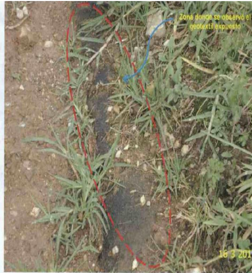
Fotografía N° 16: Vista cercana de la primera zona, ubicado en coordenadas UTM (WGS 84), 766976 N; 9253268 donde se identificó el geotextil expuesto al ambiente.
