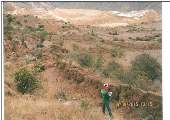
Fotografía N°120. La descarga del canal perimetral (de coronación) del Tajo Gentiles ha provocado erosiones del suelo. Hallazgo N° 19.
