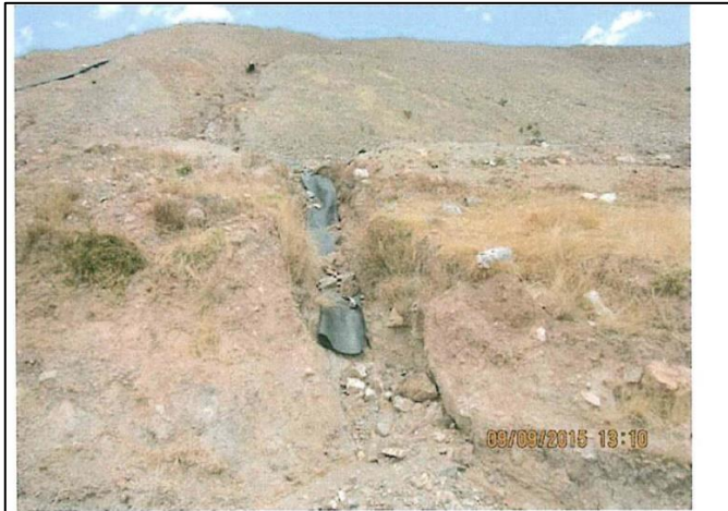
Fotografía N°112. La descarga del canal perimetral (de coronación) del Tajo Gentiles ha provocado erosiones del suelo. Hallazgo N° 19.
