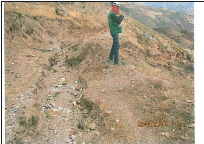
Fotografía N°115. La descarga del canal perimetral (de coronación) del Tajo Gentiles ha provocado erosiones del suelo. Hallazgo N° 19.
